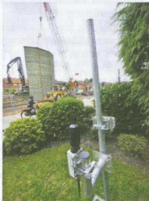
Met verplaatsbare draadloze sensoren wordt het lawaai voortdurend in de gaten gehouden. Foto: Toma Tudor
